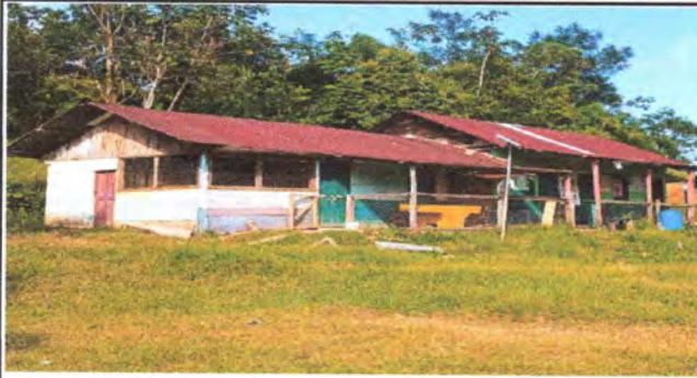
Foto1: laminas en mal estado y deteriorado
